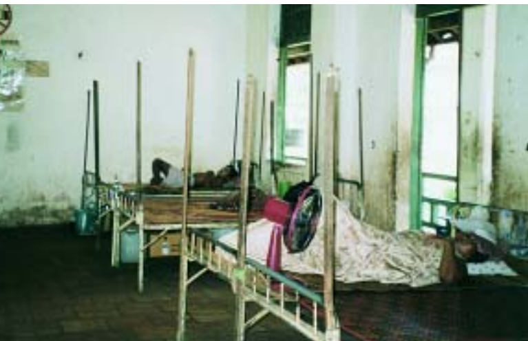
Dreck, verfallene Bau-substanz und ein Hygienestandard, der jeder Beschreibung spottete – das Krankenhaus in Kampong Thom vor der Sanierung. Das HDZ hat im vergangenen Jahr rund 115 000 Euro für das Projekt zur Verfügung gestellt.
