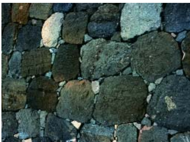
Abb. 4: Optimale Kombination großer und kleiner Füllkörper zu einem seit Jahrhunderten stabilen Mauerwerk – das heutige Prinzip des Hybridkomposites: Kombination aus Makro- und Mikrofüllkörpern.
