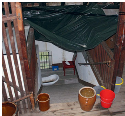
Treppenaufgang zum Boden: Von hier läuft das Regenwasser bis in den Keller.
