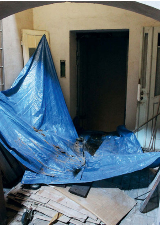
Die Pläne soll Schlimmeres verhindern und das aufgefangene Wasser in den Fahrstuhlschacht leiten, dessen Boden tiefer liegt als der Kellerboden – und dort versickern.
