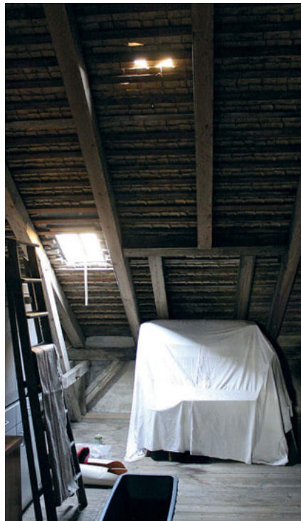
Teilweise zerstörte Dacheindeckung durch den letzten Sturm, der den Schiefer vom direkt daneben stehenden Wasserturm auf Bibliotheksdach schleuderte.
