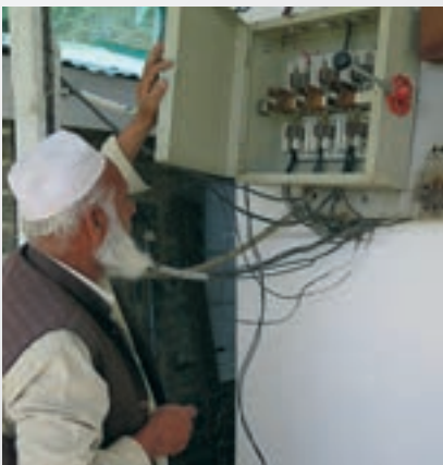
Immer wieder ein großes Problem: die (mangelhafte) Stromversorgung
