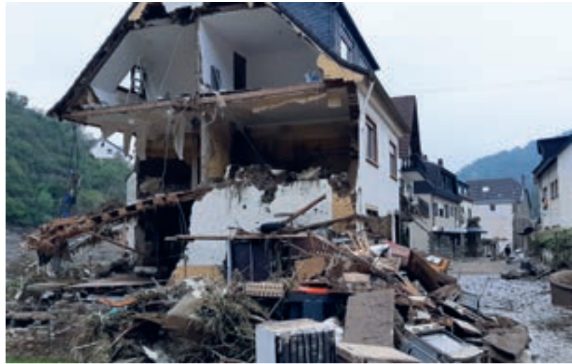
Die Straße als Trümmerfeld: Als Werner Jung am nächsten Tag in der direkten Nachbarschaft seiner Praxis mehrere eingestürzte Häuser sieht, wird ihm bewusst, wie viel Glück er hatte, dass das Praxisgebäude Baujahr 1982 dem Wasser standhielt.
