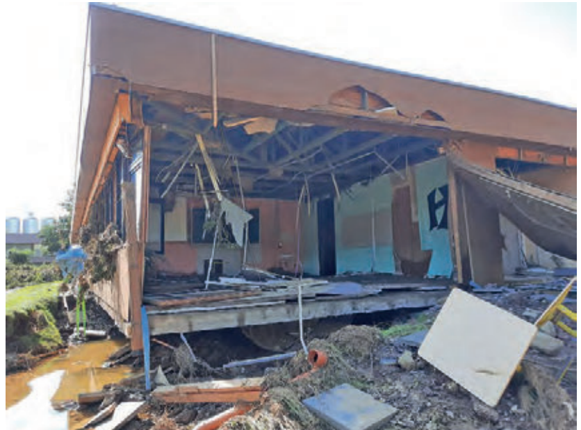
Das Wasser riss in verschiedenen Klassenräumen komplette Wände heraus.
