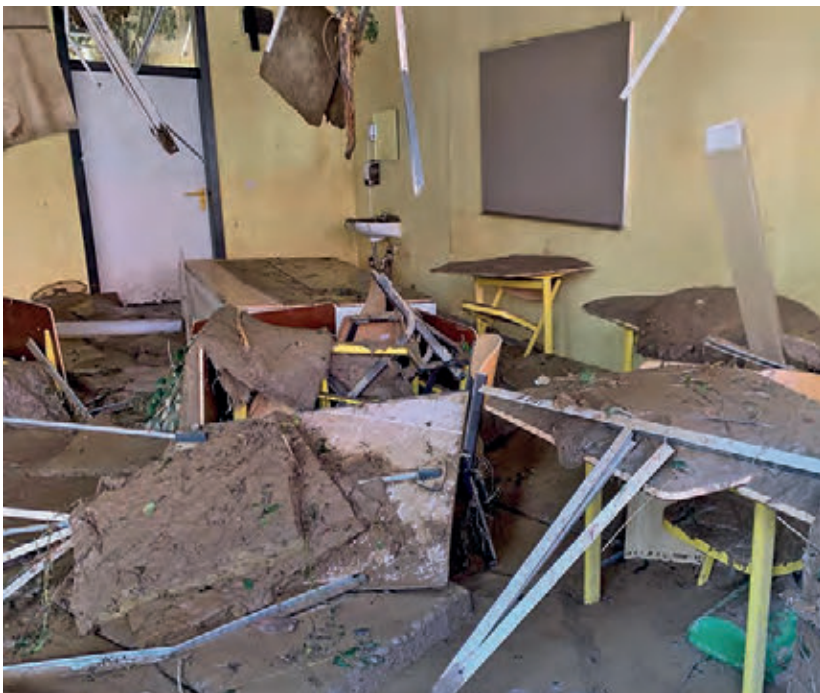
Im Erdgeschoss war alles komplett überflutet und ist zerstört worden. Hier stand das Wasser über vier Meter hoch. Auch im Außenbereich sind alle 20 Unterrichtsräume nicht mehr nutzbar.
