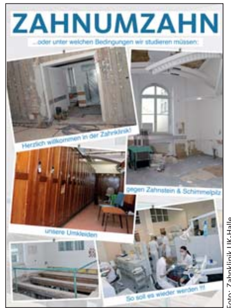
Die Bürgerinitiative „ZahnumZahn“ hatte auf die unmöglichen Bedingungen nach einem Wasserschaden aufmerksam gemacht und Spenden für den Neubau eingeworben.
